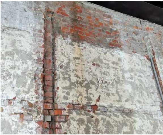
圖 3 發現牆壁上滲水區域痕跡 （圖片來源／成大博物館）
