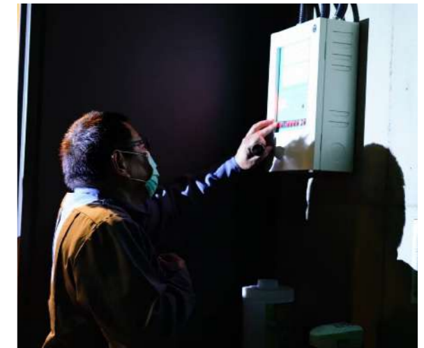
圖 2 確認極早期火災預警系統警報之庫房位置。(圖片來源／呂錦瀚)
